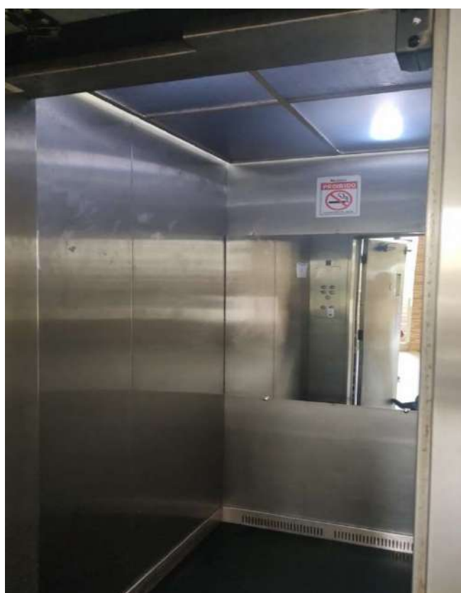
Foto 55 - Vista Interna do elevador, com ênfase ao espelho e paredes. Encontra-se em bom estado de conservação.
