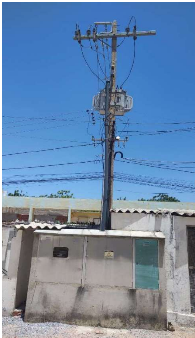
Foto 51 - Subestação de energia elétrica aérea do hotel. Sistema localizado na área térrea, lateral do hotel.
