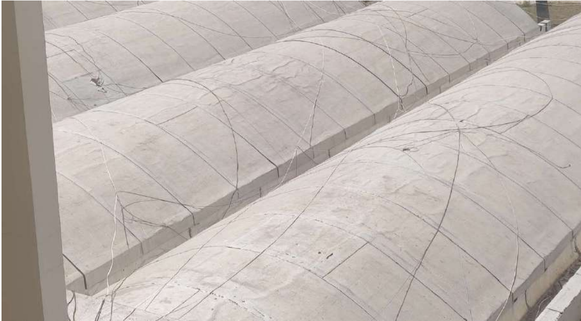
Foto 34: Teto da entrada do Hotel - Cabeamento/fiação lançada sobre a cobertura inferior frontal do hotel sem nenhum critério, descumprindo todas as normas em vigor, inclusive ferindo os aspectos de segurança do empreendimento.
