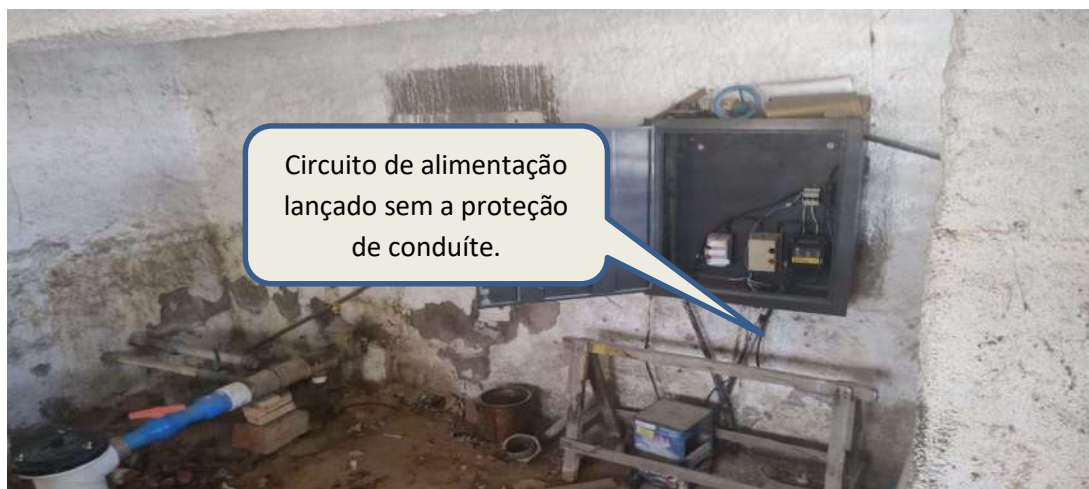
Foto 35: Situação precária do quadro de comando de bombas da piscina
