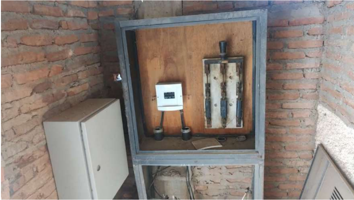
Foto 52 - Sistema localizado próximo ao transformador.
