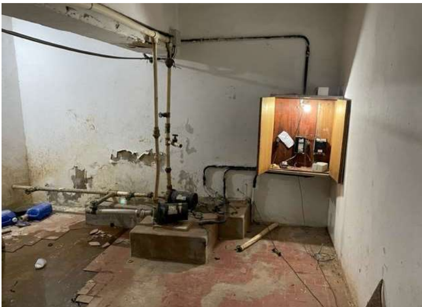
Foto 61 - Registramos também painel fora de especificação, haja vista composição de madeira no seu interior.
