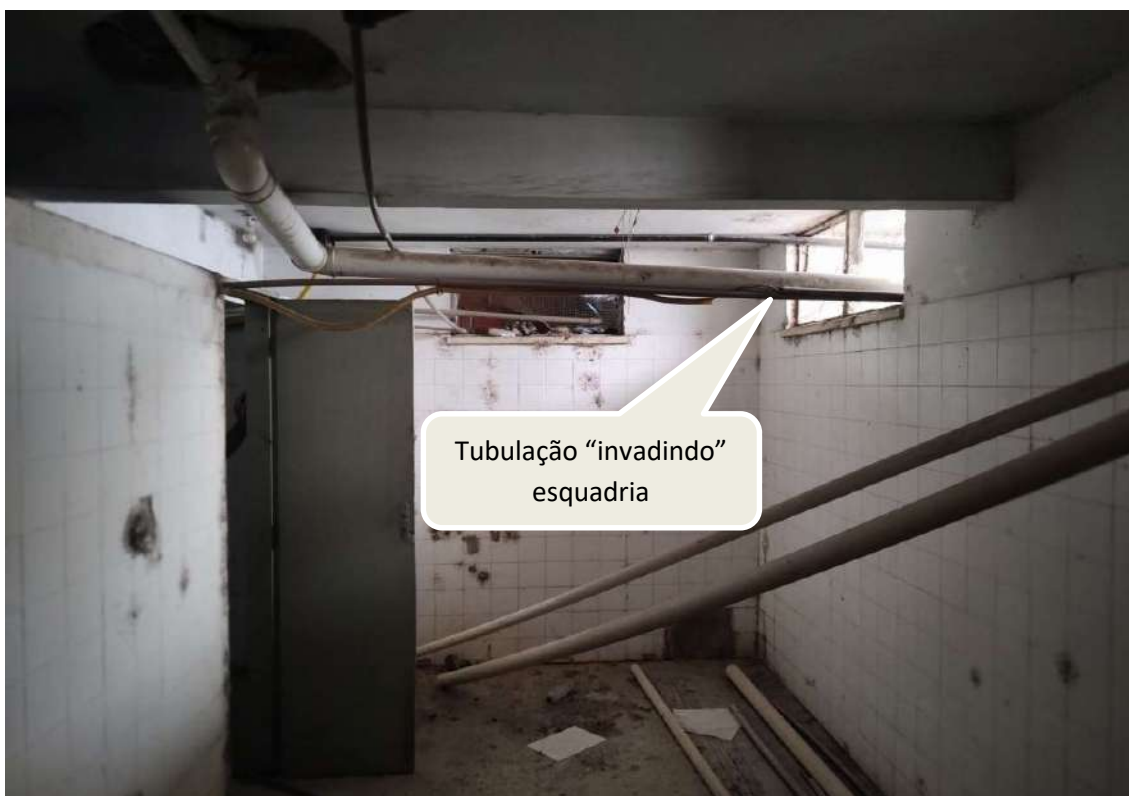
Foto 28: Tubulação em pleno funcionamento, disposta de maneira inadequada e fora de normativos, posicionada passando pelo interior de esquadria.
