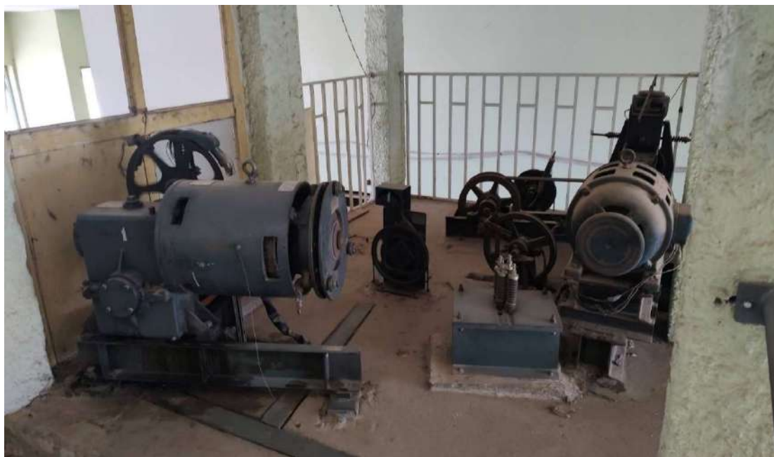
Foto 56 - Casa de máquinas dos elevadores.
