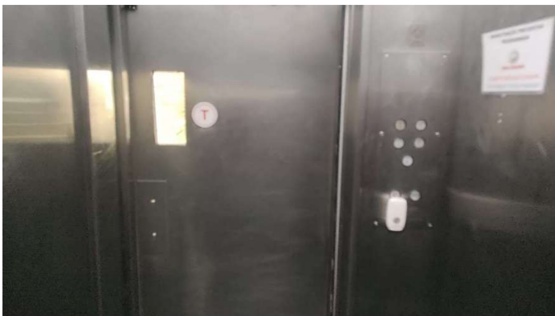
Foto 54 - Vista Interna do elevador, com ênfase a porta e botoeiras
