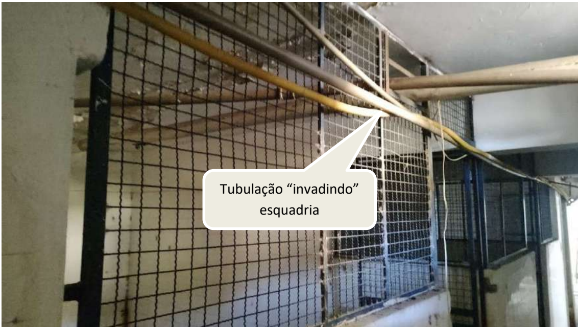
Foto 29: Tubulação em pleno funcionamento, disposta de maneira inadequada e fora de normativos, posicionada passando pelo interior de esquadria.
