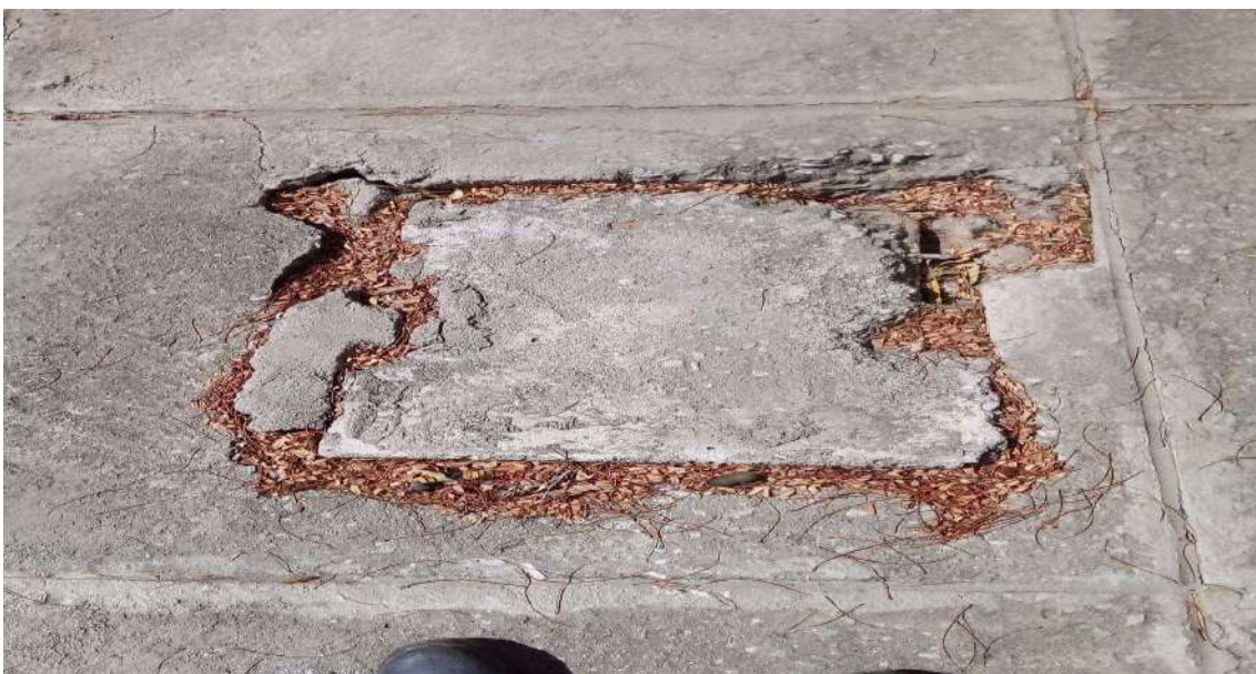
Foto 30: Tapa de caixa de esgoto quebrada. Mesma situação para outras existentes.
