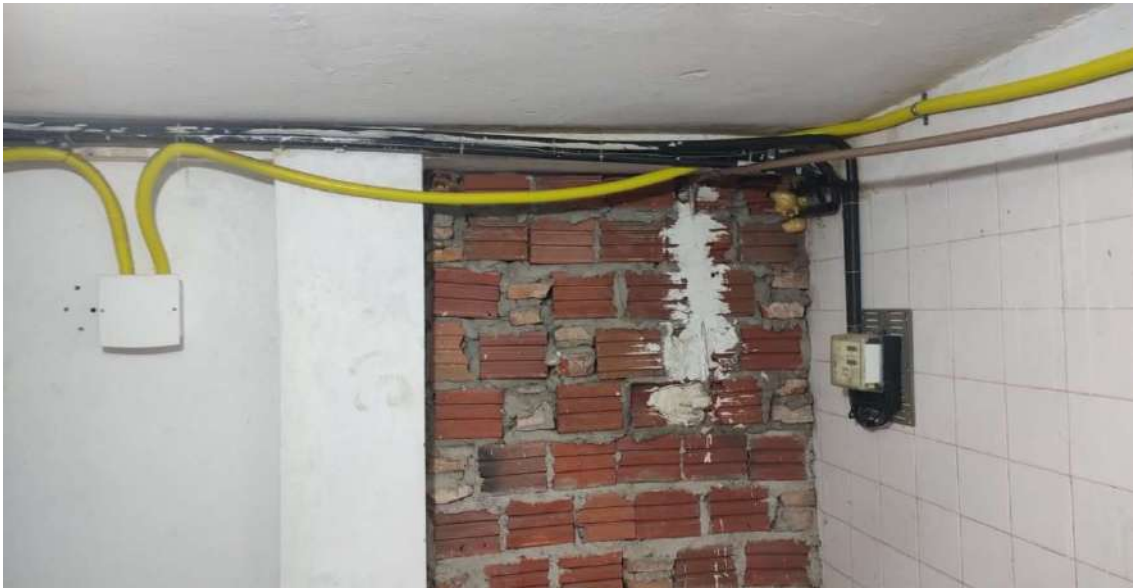
Foto 51 - Eletrodutos flexíveis e rígidos expostos, assim como quadros de passagem e medidor de energia.
