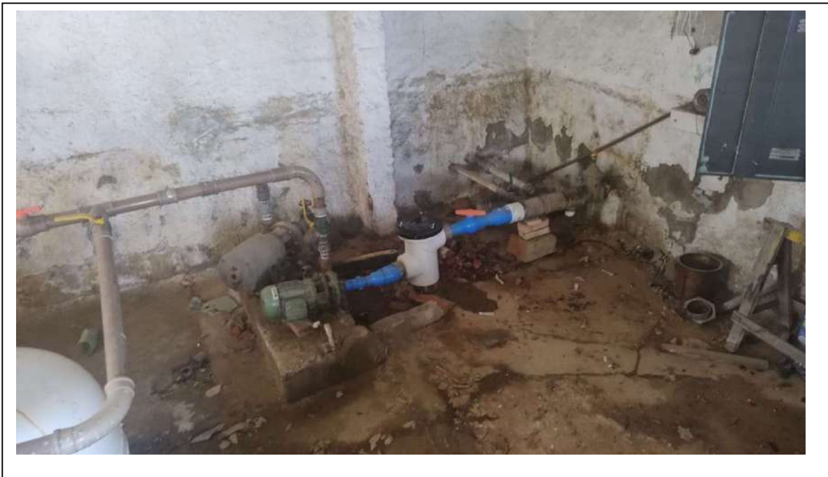
Foto 38: Instalações de bombas e filtros em casa de bombas deteriorada.
