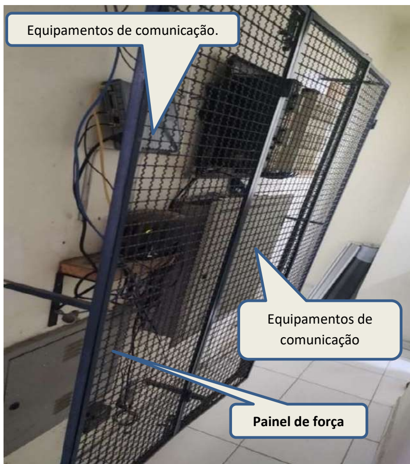
Foto 50: Quadros de comando e controle de fornecimento de energia elétrica, telefonia, dados e voz, protegidos por tela tipo grade metálica.
