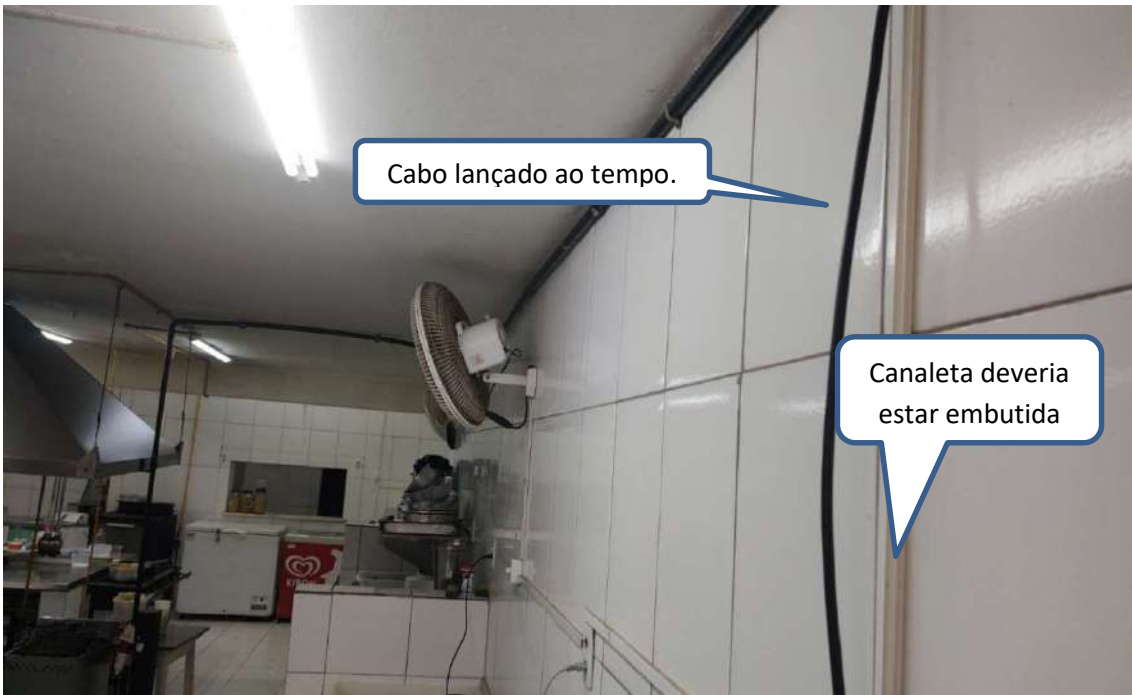
Foto 41: Numa parede da Cozinha, cabos e eletrodutos fixados externamente a parede.
