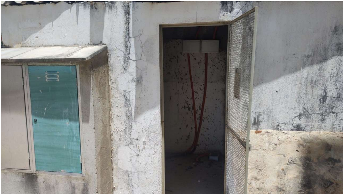
Foto 63 - Vista da casa de comando e controle "local", que abriga o disjuntor, medidor de energia e demais acessórios de entrada de energia.
