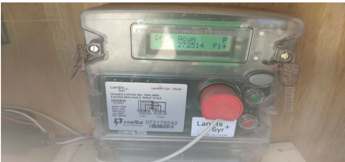
Foto 64 - Quadro de medição de energia do hotel.
