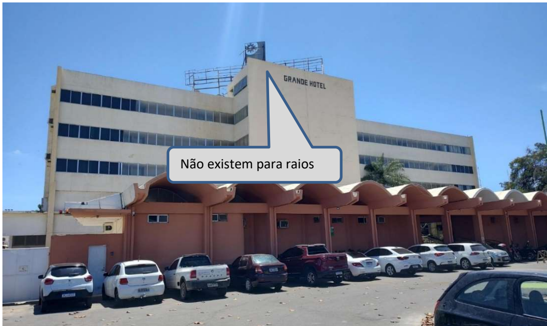
Foto 69 – Vista no topo da fachada do hotel, onde não se verifica a presença de para raios.
