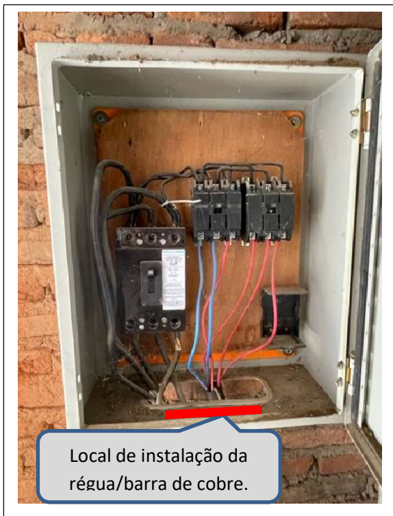
Foto 67: Ausência de barramento
