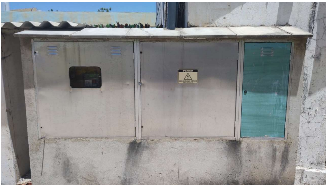
Foto 61 - Quadro Geral de Comando da Subestação
