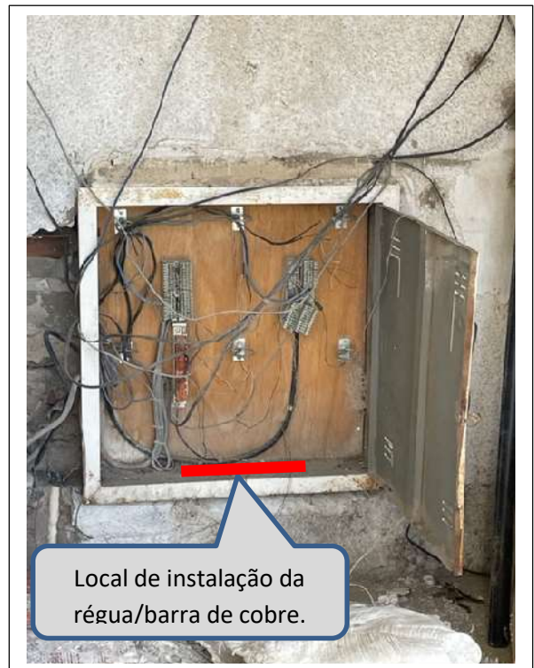
Foto 68: Ausência de barramento
