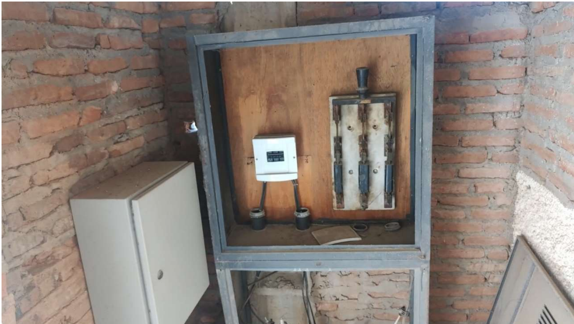
Foto 62 - Disjuntor de entrada de energia, lado de baixa tensão do transformador. Chave faca, trifásica já desativada.
