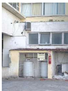
Foto 37 – Imagem da central de GLP da cozinha
