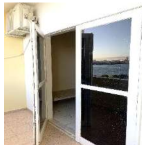
Foto 68 – Vista porta da varanda e condensadora do split
